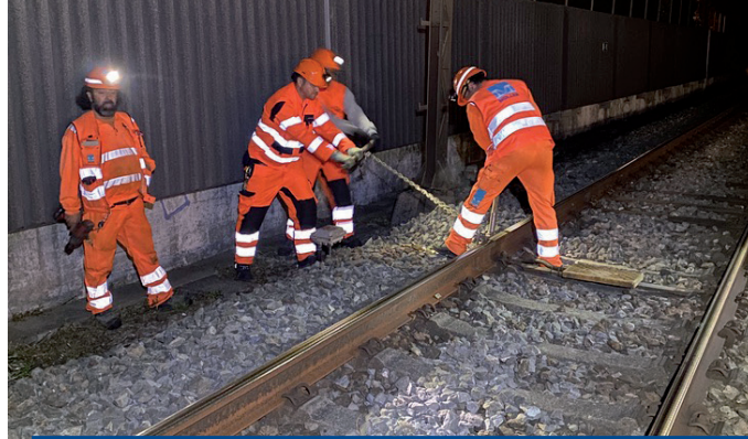
Einbau Zugsicherungssystem ETCS, Anschluss verlegter Kabel in Kabelverteiltern und den Elementen der Aussenanlage, interne Verdrahtungen in Relaisräumen, Spleissungen von Glasfaser- und Kupfer-Kabeln
