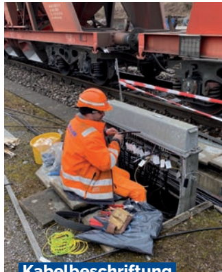
Kabelbeschriftung an Verteilern
