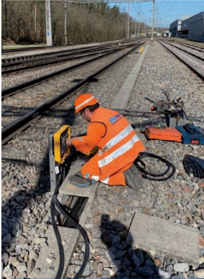
Montage und Unterhalt von Sicherungs-Aussenanlagen sowie Mithilfe bei werk- und sicherungsorientierten Prüfungen B
